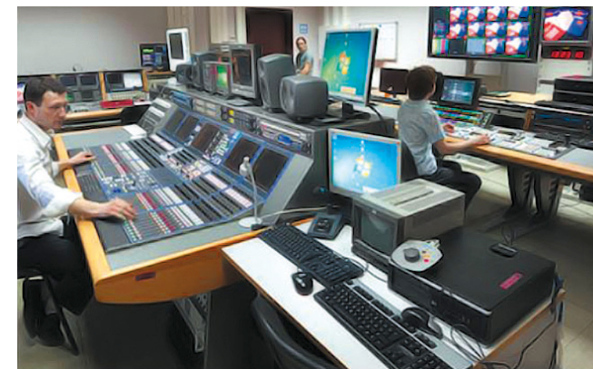
Пульт управления в аппаратной выпуска телевизионных программ перед началом эфира проверяется и настраивается инженером
