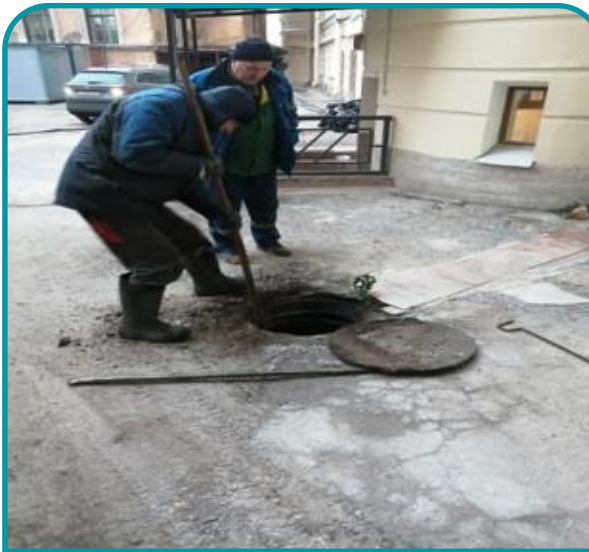
246 засоров внутренней системы канализации
