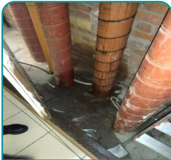
164 прорыва системы отопления и ГВС
